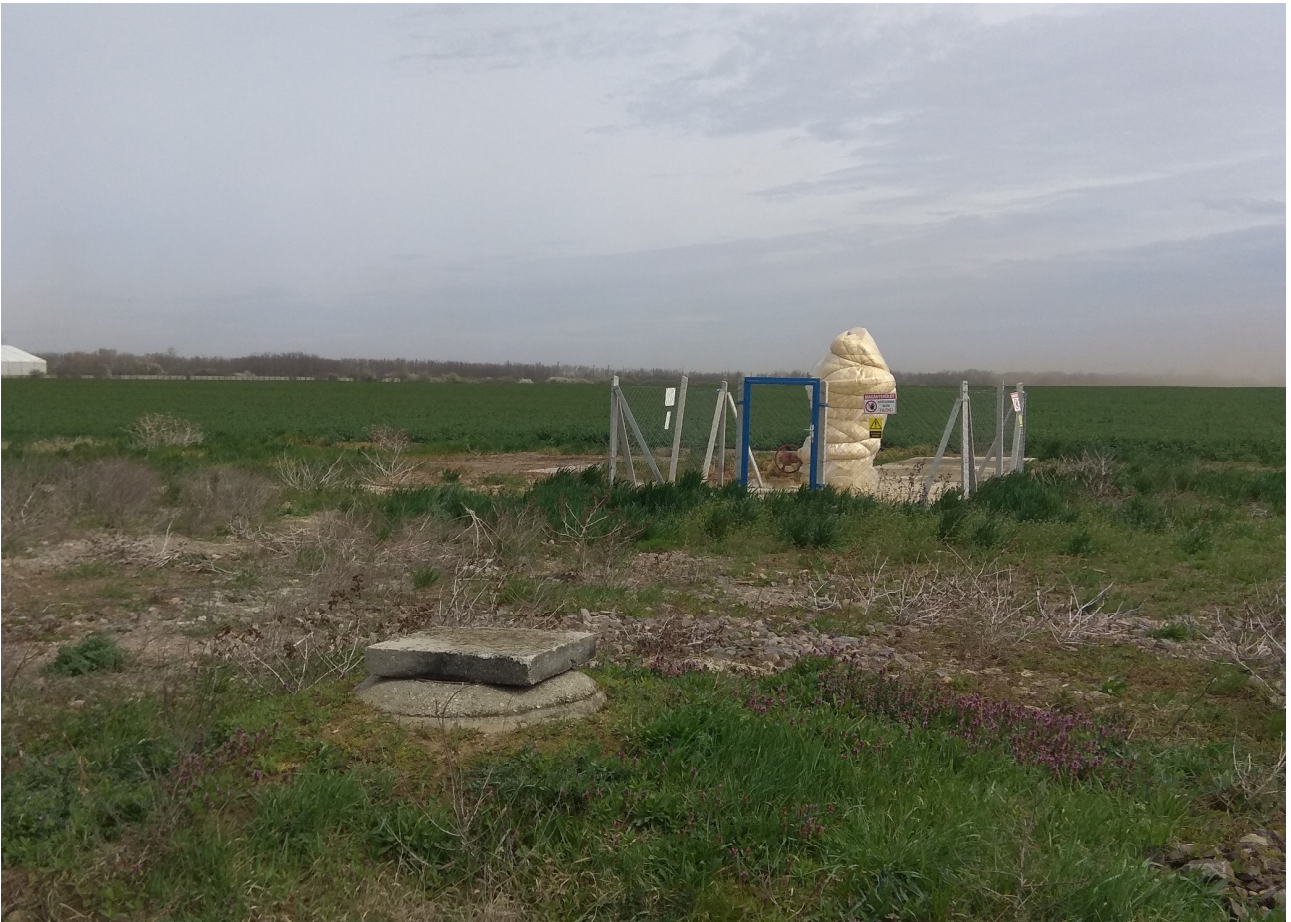
Lezárt, fagymentesített termáلكút és a belső hálózat aknája
